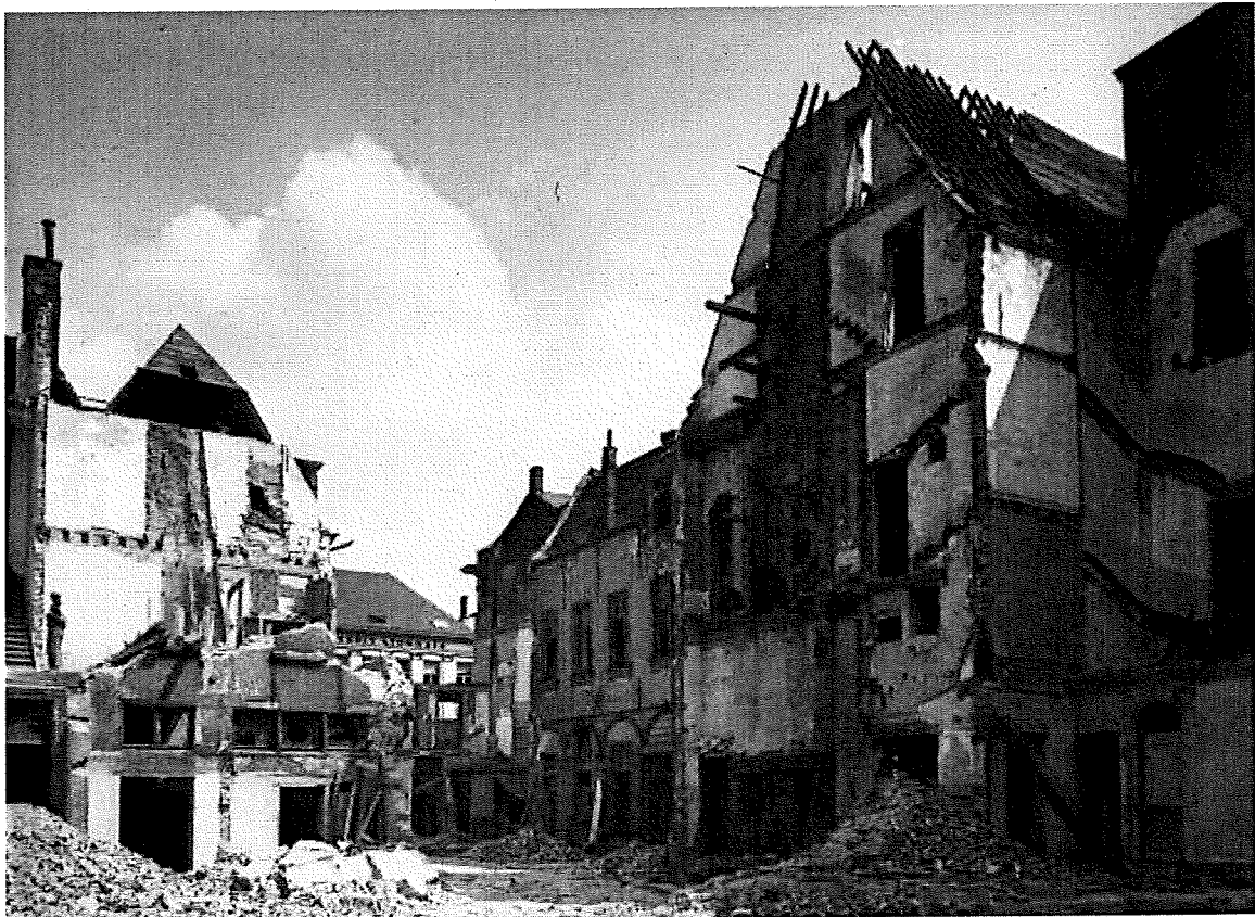
Het complex tijdens de afbraak. ©Architectuurarchief Provincie Antwerpen, archief Lode De Barsée
