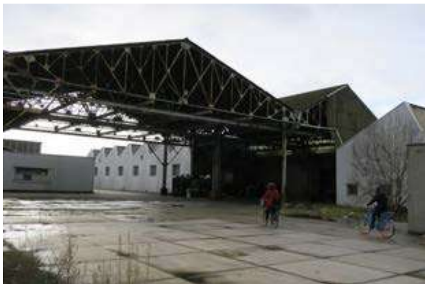
Figuur 121: huidige situatie dak
