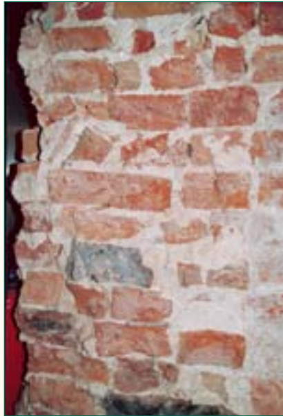
'Oud Schepenhuis', Steenweg: bakstenen vulling met kloostermoppen in een muur van het 'Nieuw' Schepenhuis dat in 1374-1375 werd gebouwd.
