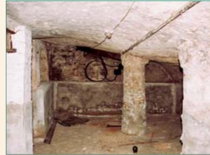
'Rupelmonde', IJzerenleen: later toegevoegde zuilen in baksteen ter ondersteuning van de verzakking van het gewelf
