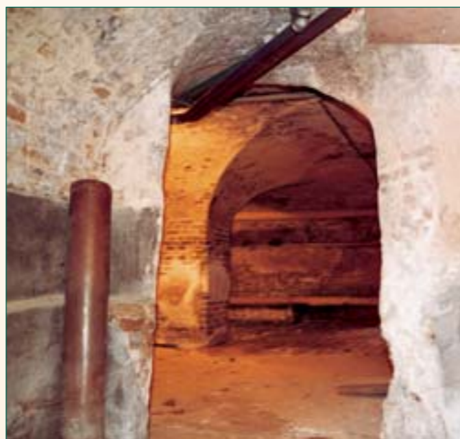
'Betaniënklooster', later 'De Posthoorn', Schoutetstraat: ca. 1,20m hoge voorzetmuurtjes bestreken met een waterdichte bepleistering en een terracottabuis in de hoek beschermen deze kelder tegen wateroverlast
