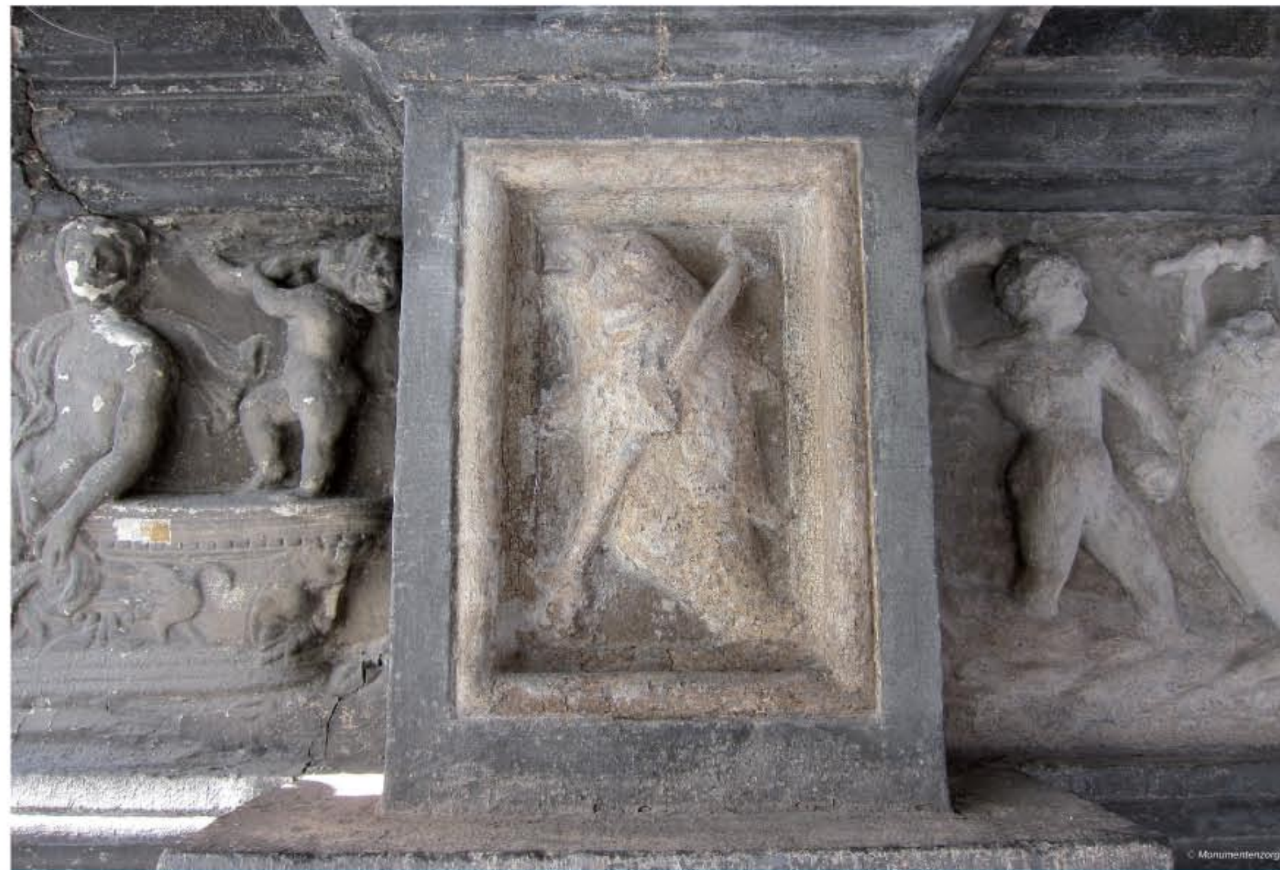
▲ De proefrestauratie werd in 2012 uitgevoerd op het entablement (fries, triglifekoppen, architraafbalk en kroonlijst), het timpaan, het boogveld, de voluutvormige consoles en de zuilen van de uiterst rechtse travee boven de gelijkvloerse verdieping.
