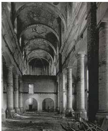
De 19de-eeuwse tussenniveaus in de midden- en zijbeuken van de kerk verdwenen na een brand in 1946. De tussenmuur aan het koor geeft aan op welke hoogte de afgebroken niveaus zich bevonden.
