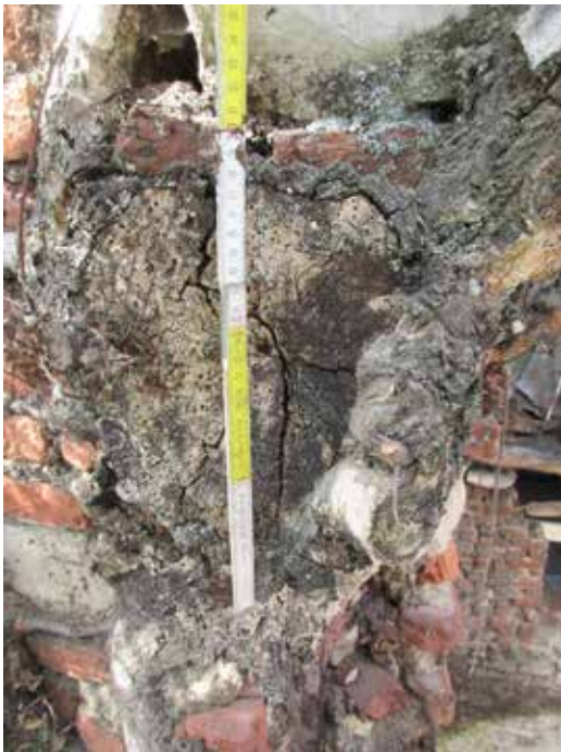
Inmenging van boomstammen en wortels in het gevelmetselwerk.
