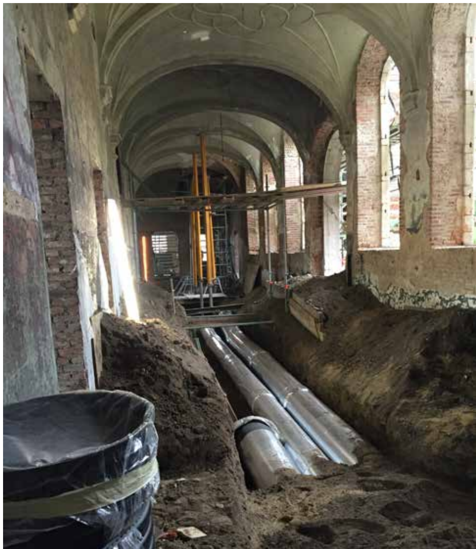
Technieken (ventilatiekanalen) in pandgang noord
