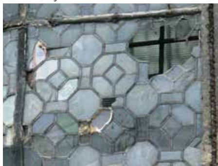
Detail van een blank glas-in-loodraam vóór restauratie.
