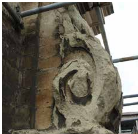
Detail van een verweerde voluut in Lediaanse kalksteen vóór restauratie. © architectenbureau Studio Roma
