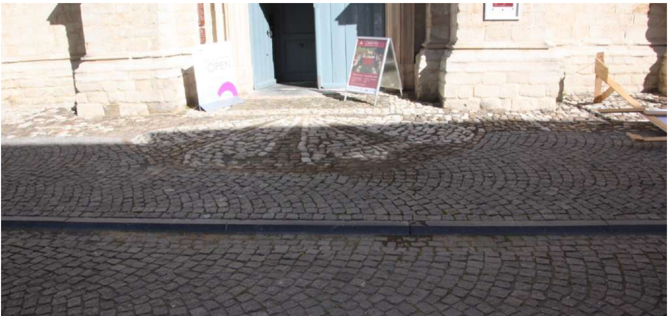
Afbeelding 89 Zicht op de kasseien in de Nonnenstraat met zichtbare mosgroei in de voegen
